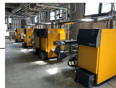
チップボイラー
