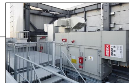
非常用発電機（大崎ウィズタワー）
