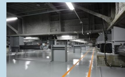
京橋エドグランの免震装置
