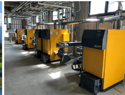
チップボイラー
