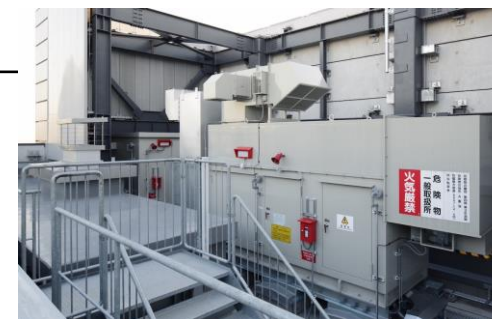
災害時に電力を供給する非常用発電機（大崎ウィズタワー）
