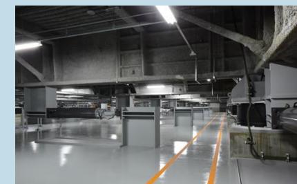
京橋エドグランの免震装置
