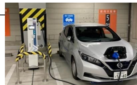
新丸の内センタービルディングのEV充電器
