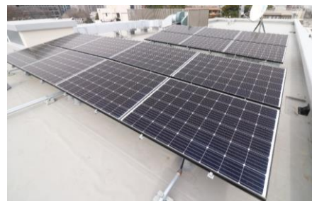
太陽光パネル
