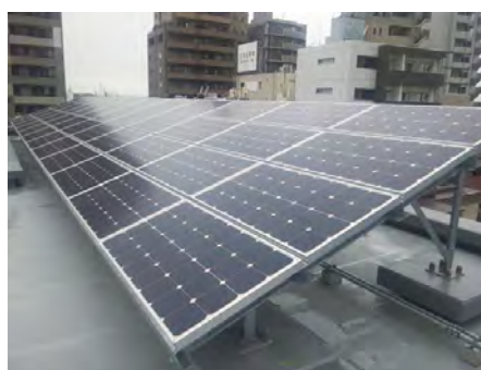
太陽光発電パネル(参考写真)
